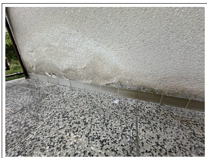
Vlhkostní poruchy (obvodové zdivo sousedního domu na terase).
