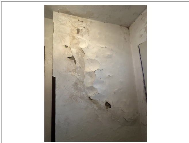
Vlhkostní poruchy v suterénu.
