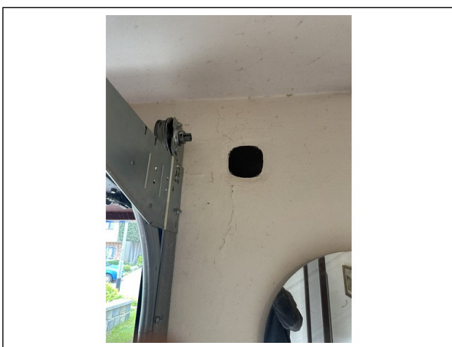
Trhliny v omítce.
