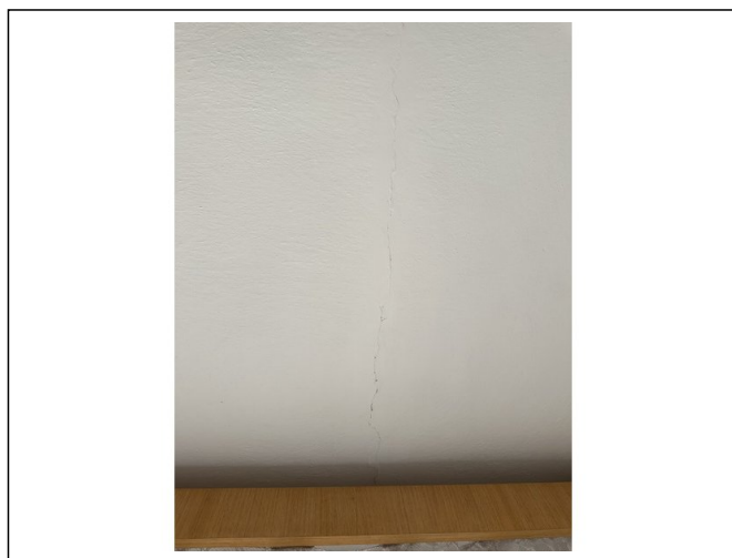
Trhlina v úrovni stropů v místě uložení nosníku.
