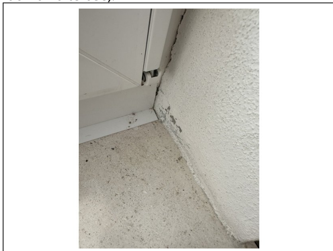
Znečištění omítek v blízkosti okna.
