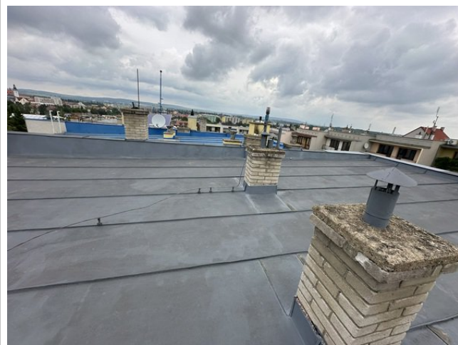
Bleskosvod není ukončen jímací tyčí.
