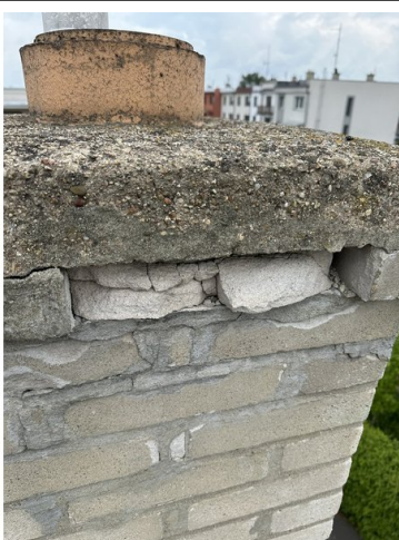
Chybějící cihly v komínovém tělese.
