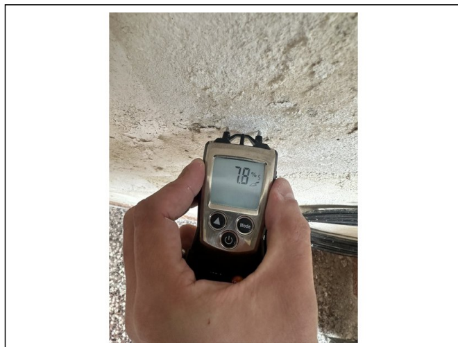
Zvýšená vlhkost cca 7,8%.
