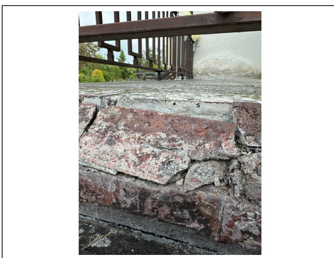
Degradace povrchu terasy.
