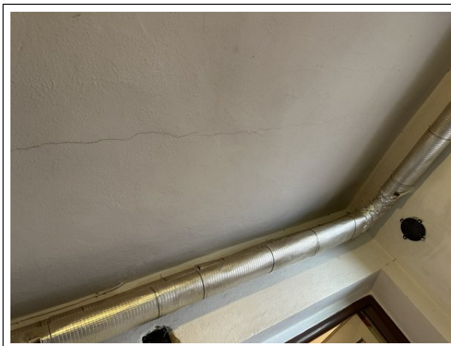
Trhlina ve stropu v místě stropního nosníku.
