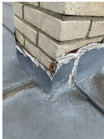
Trhlinky v tmelení hrany oplechování (riziko netěsností).
