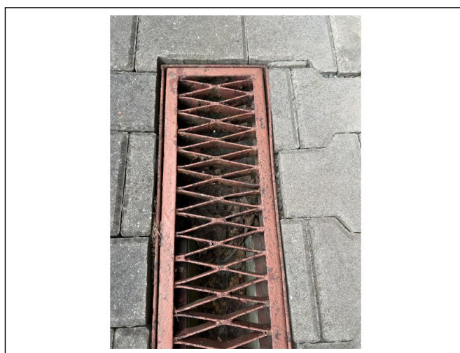
Žlab u vjezdu do garáže v suterénu je zanesený nečistotami.
