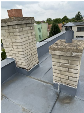
Překážky, bránící plynulému odtoku vody ze střechy.
