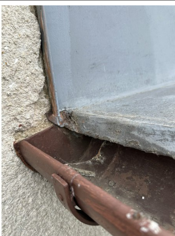
Degradace nátěru krytiny a okapového žlabu.
