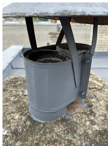
Azbestocementový materiál (potrubí).
