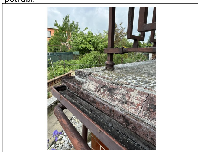
Degradace povrchu terasy.
