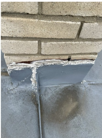
Voda se může zdržovat za komínem, který brání odtoku.
