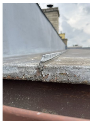
Degradace nátěru krytiny a okapu.
