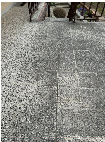
Netěsnosti v nášlapné vrstvě terasy - zjištěno zatékání skrze skladbu terasy.
