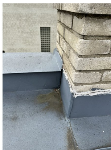
Detail koutu, kde se může zdržovat voda.
