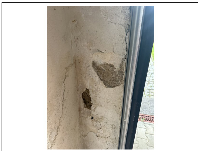
Vlhkostní poruchy v suterénu.
